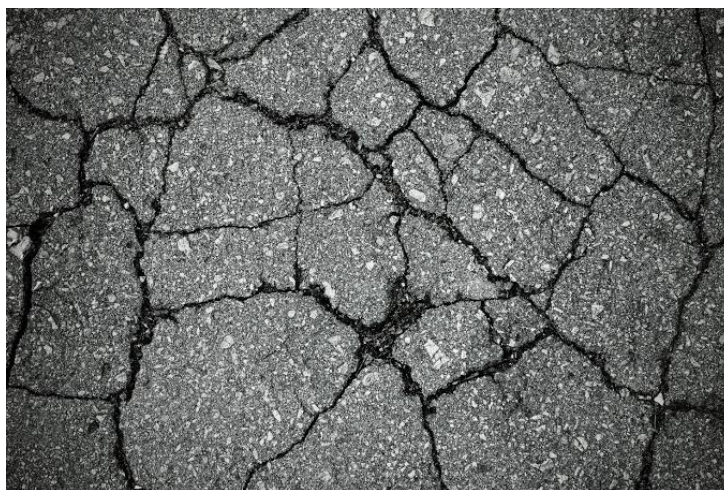
Figura 3 – Exemplo de rachaduras
