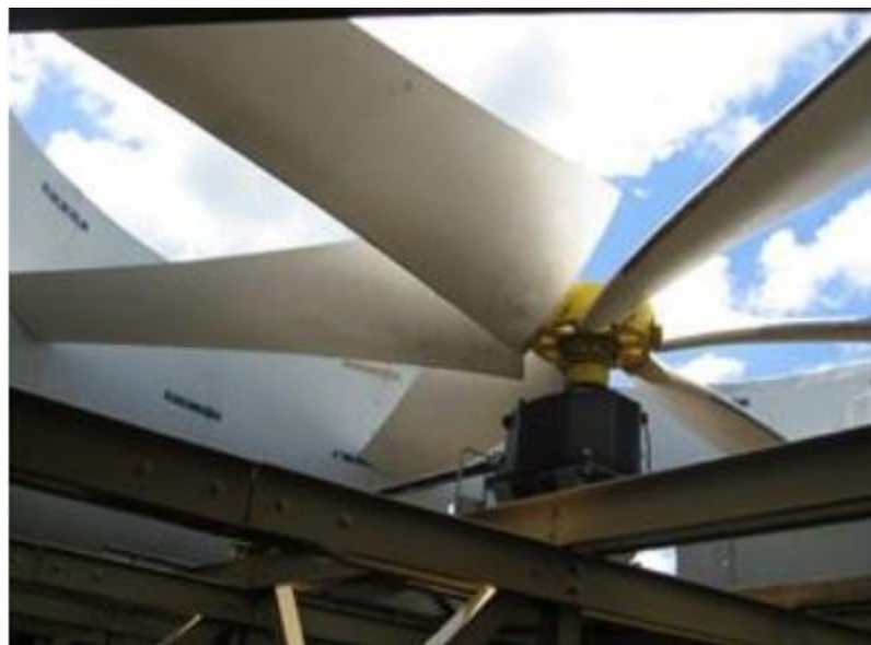
Figura 4 – Ventilador de uma torre de resfriamento.
